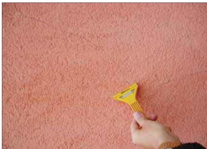
Obr. 8 Vada fasádního systému
