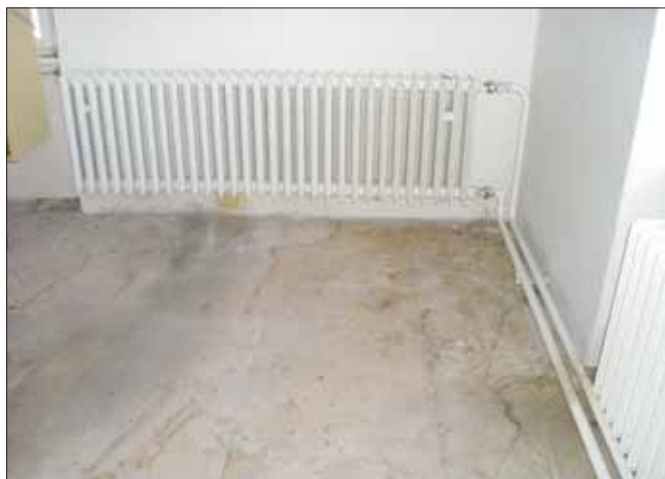
Obr. 12 Poškozený radiátor ve 3. NP
