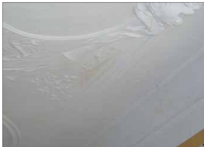
Obr. 15 Poškození stropu sekretariátu ve 2. NP
