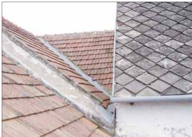
Obr. 17 Problematické místo sousedících staveb – průmět střešních rovin
