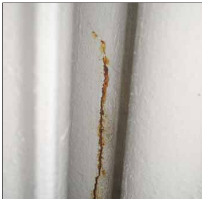
Obr. 13 Detail poškození radiátoru
