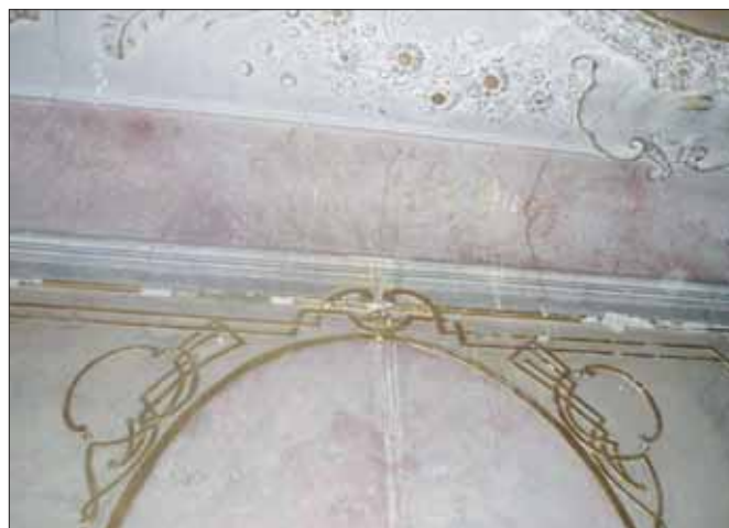
Obr. 14 Poškození na stropě kapličky ve 2. NP
