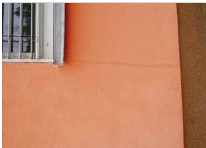
Obr. 6 Vada fasádního systému
