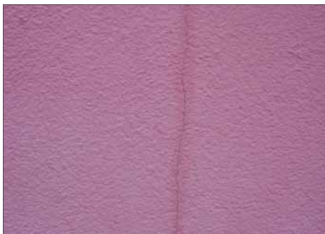
Obr. 7 Vada fasádního systému
