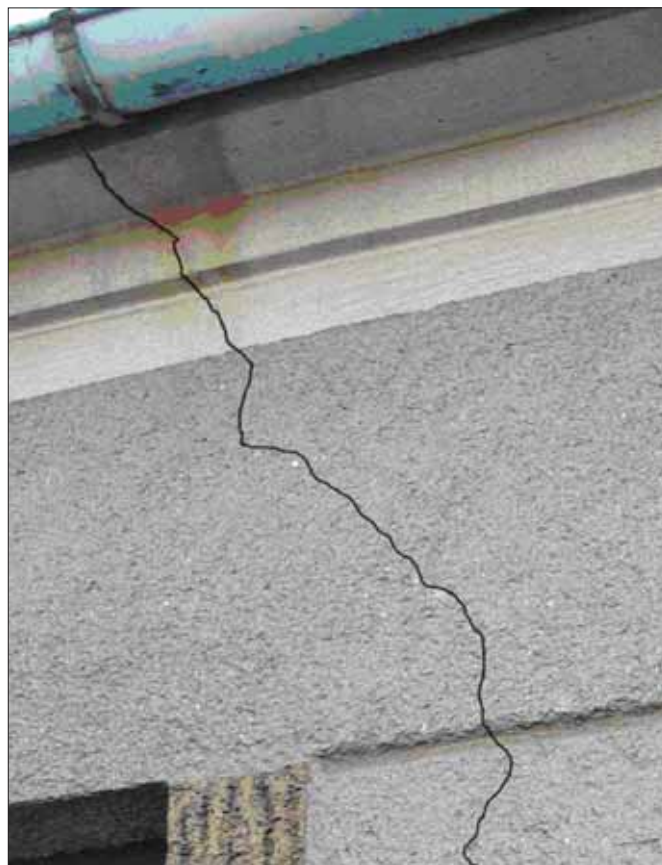
Obr. 2 Trhlina v římsce přízemní části
