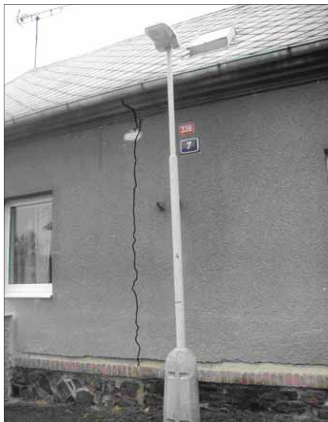
Obr. 3 Trhlina na rozhraní podsklepené a nepodsklepené části domu
