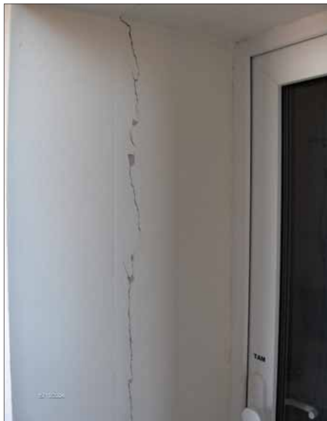
Obr. 7 Trhlina v dilatační spáře
