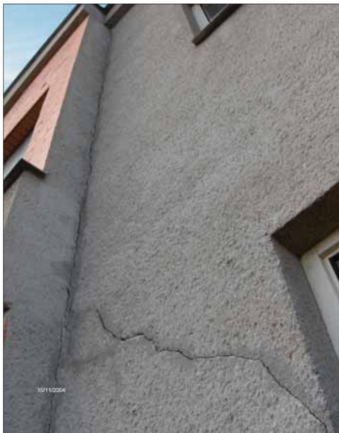
Obr. 6 Trhlina ve vyzdívce skeletu a na rozhraní schodišťového přístavku
