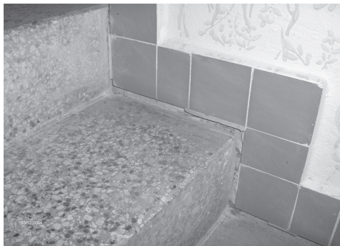
Obr. 2 Trhlina na rozhraní schodišťového ramene a stěny, způsobená reologickým průhybem schodišťového ramene
