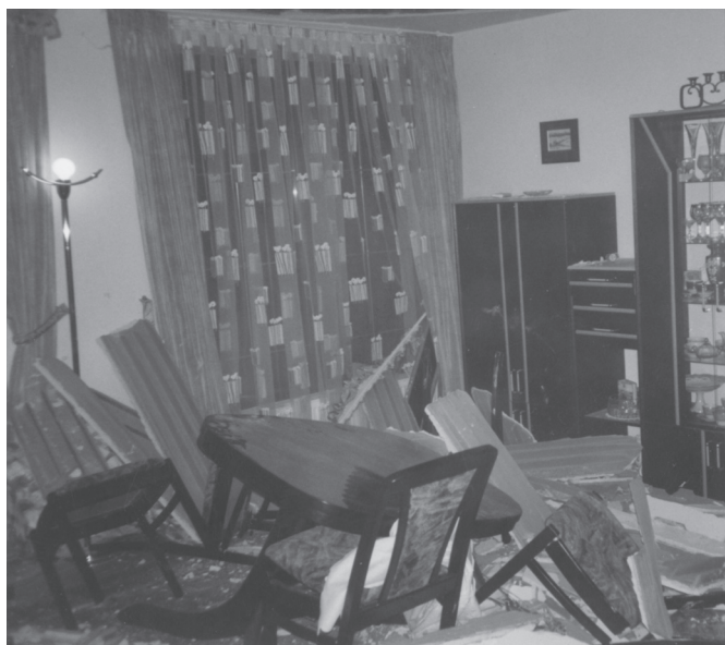
Obr. 4 Havárie hrdiskového stropu.
