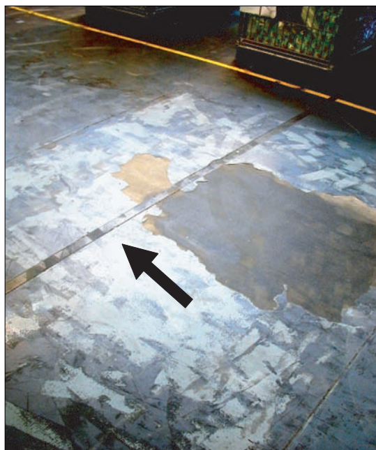
Obr. 1 Poruchy podlahových desek v poli
