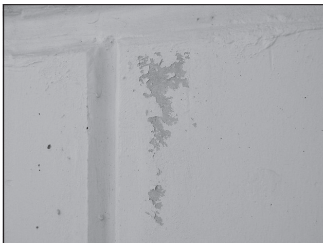
Obr. 7 Odlupování nátěru v důsledku nízké přídržnosti k podkladu.
