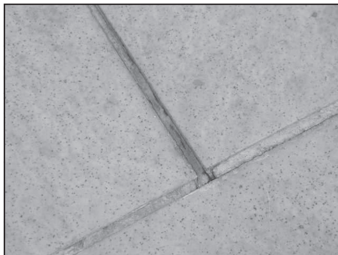
Obr. 10 Mrazové narušení dlažby zamrznáním vody vniklé sparami.
