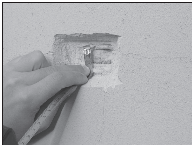
Obr. 6 Trhliny vznikající nad příliš širokými sparami zdiva.
