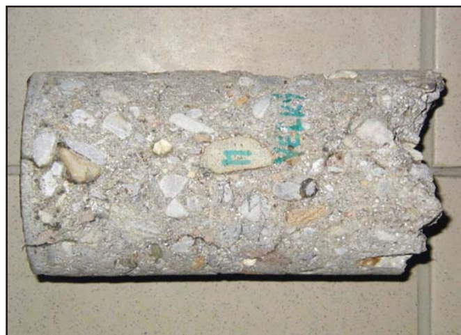
Obr. 3 Narušení betonu v důsledku alkáliového rozpínání.
