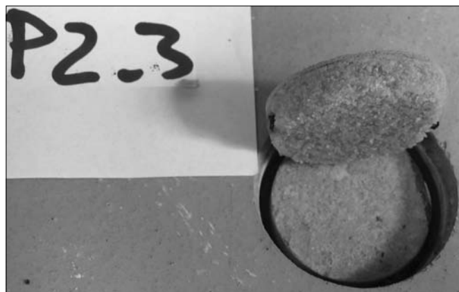
Obr. 6 Charakter poškození posuzovaného souvrství v místech zkoušek přídržnosti
